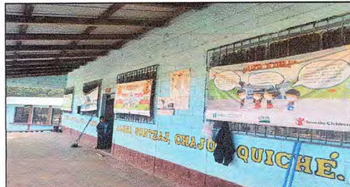
Foto 4: MODULO 1 susticion de los vidrios de todas las Aulas de la Escuela, tanto enfrente y atrás.
