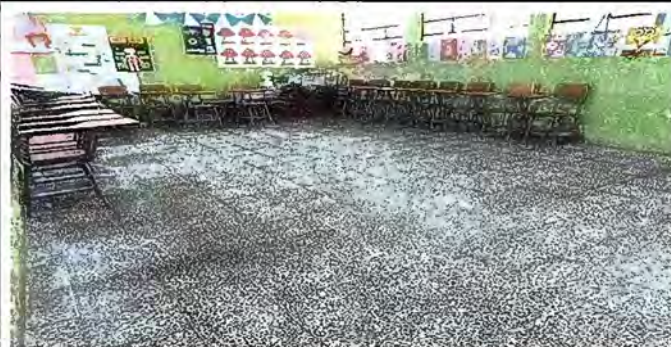
Foto 2: Sustrucción de piso de granito.
