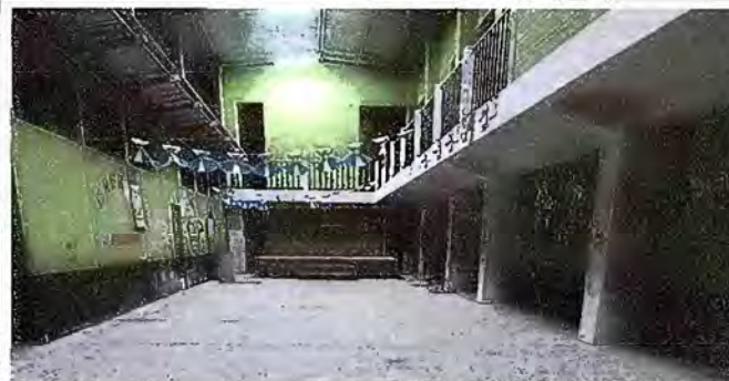
Foto 4: Sustrucción de piso de granito.
