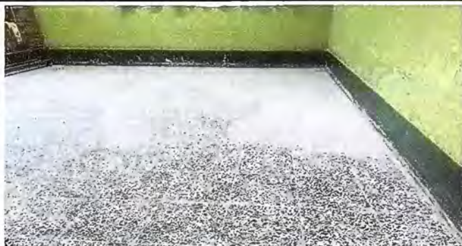
Foto 1: Sustrucción de piso de granito.
