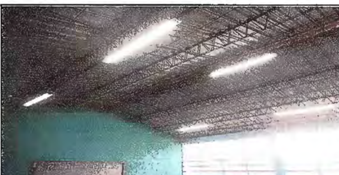
FOTO 18. MÓDULO 5: Sustitución de lámparas 2 x 40.
