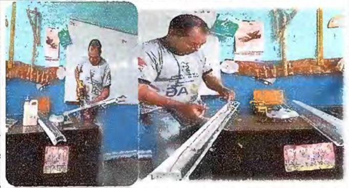
FOTO 2. MÓDULO 1: Sustitución de lámparas 2 x 40.
