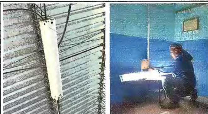
FOTO 15. MÓDULO 4: Sustrucción de lámparas 2 x 40
