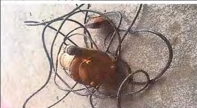
FOTO 22. AREA EXTERIOR: Sustrucción denbomba de agua.
