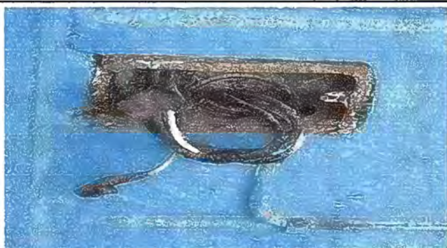
FOTO 3. MÓDULO 1: Sustitución de toma corrientes doble.
