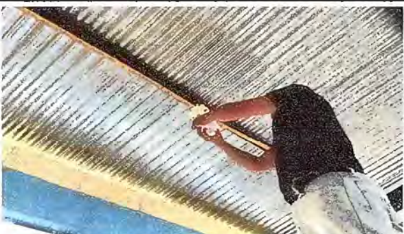
Foto 3. Módulo 2: Sustitución de focos ahorradores.
