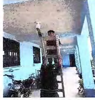
Foto 8 Módulo 2: Sustitución de focos ahorradores
