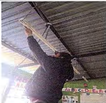
Foto 3: Módulo 1. Sustitución de lámparas led.
