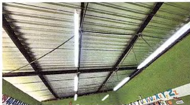
Foto 3: Módulo 1. Sustitución de lámparas led.
