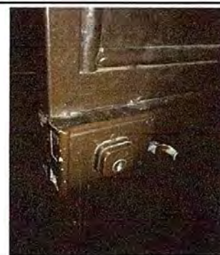
Foto 6: MODULO 1: Sustrucción de chapa
