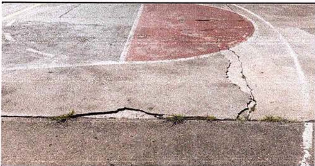
Foto 5: Cancha polideportiva. Torta de concreto
