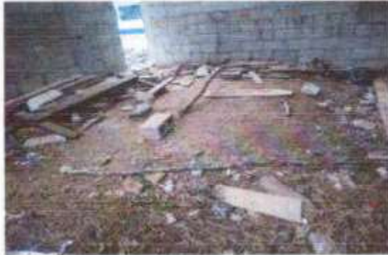
Foto 1: REPELLO, CERNIDO EN PAREDES DE COCINA, REPARACION DE MUROS.
