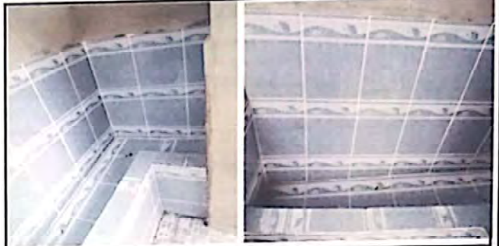
FOTO 8: MANTENIMIENTO DE MIGITORIO Y TAPA DE FOSA
