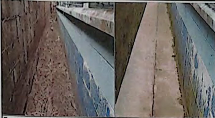
Banqueta de protección módulo 1
