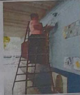
Foto 2: CAMBIO DE LAMPARA LED
