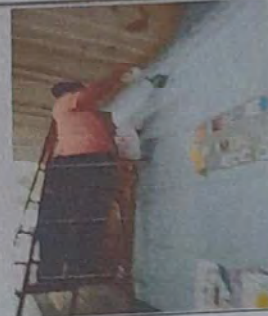
Foto 4: CAMBIO DE LAMPARA LED
