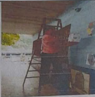
Foto1: CAMBIO DE LAMPARA LED
