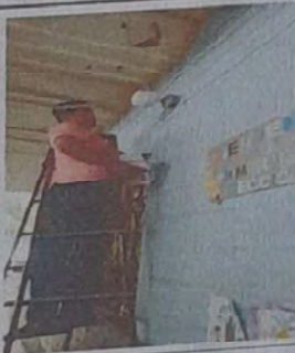
Foto 5: CAMBIO DE LAMPARA LED
