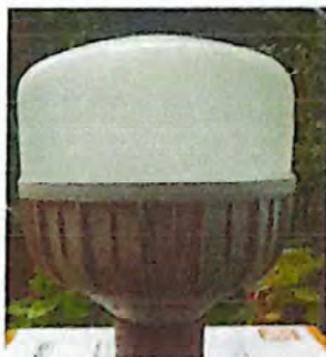
Foto 5: CAMBIO DE LAMPARA LED
