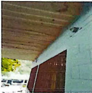
Foto 1: CAMBIO DE LAMPARA LED
