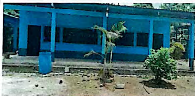
Foto 5: ESTADO DE BALCONES DE MODULO 1
