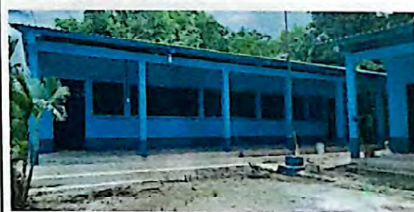
Foto 6: ESTADO DE PISO Y BANQUETA EN MODULO 2
