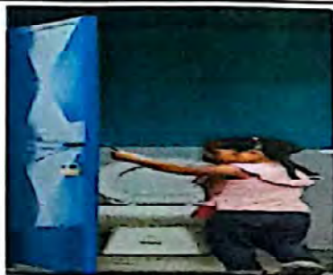
Foto 1: ESTADO ACTUAL DE SANITARIOS
