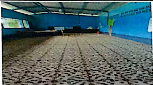
Foto 3: ESTADO DE PISO EN AULA DE MODULO 2
