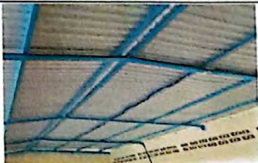
Foto 1: ESTADO DE TECHO E ILUMINACION EN INTERIOR DE AULA MODULO 2
