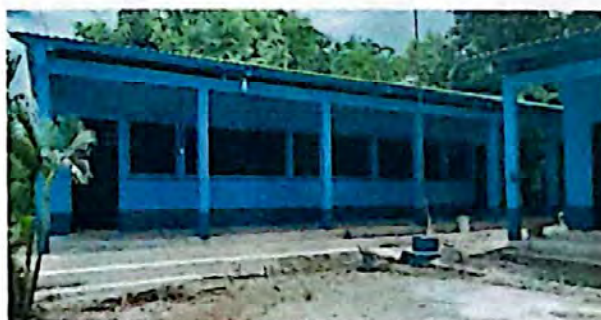
Foto 6: ESTADO DE PISO Y BANQUETA EN MÓDULO 2
