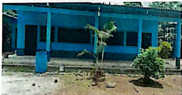
Foto 5: ESTADO DE BALCONES DE MÓDULO 1
