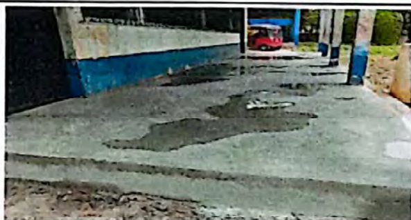
Foto 3: ESTADO DE PISO EN CORREDOR DE MODULO 1
