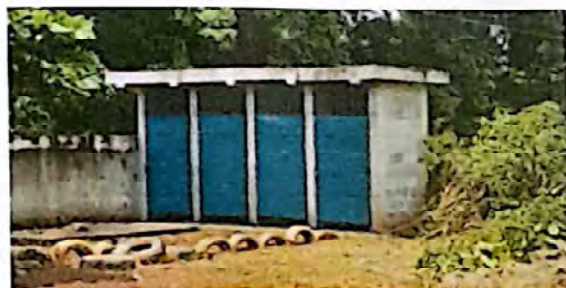
Foto 2: ESTADO FISICO DE MODULO DE SANITARIOS
