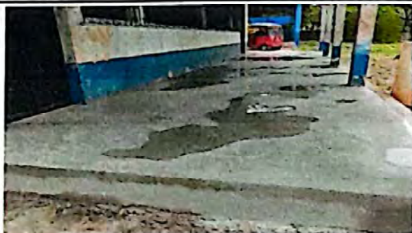
Foto 3: ESTADO DE PISO EN CORREDOR DE MÓDULO 1
