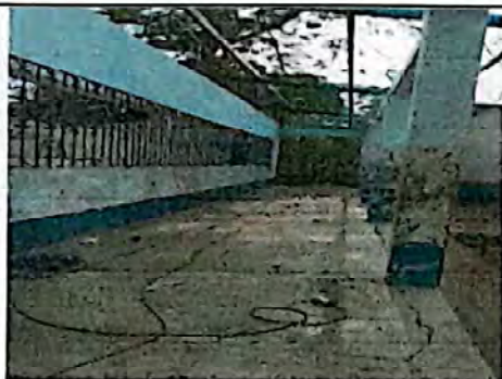
Foto 3: ESTADO DE PISO EN CORREDOR DE MÓDULO 1
