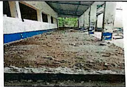
Foto 6: ESTADO DE PISO Y BANQUETA EN MODULO 2
