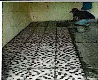
Foto 3: ESTADO DE PISO EN AULA DE MODULO 2
