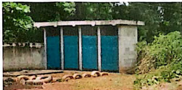
Foto 2: ESTADO FÍSICO DE MÓDULO DE SANITARIOS
