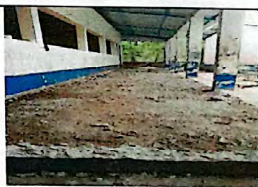
Foto 6: ESTADO DE PISO Y BANQUETA EN MÓDULO 2
