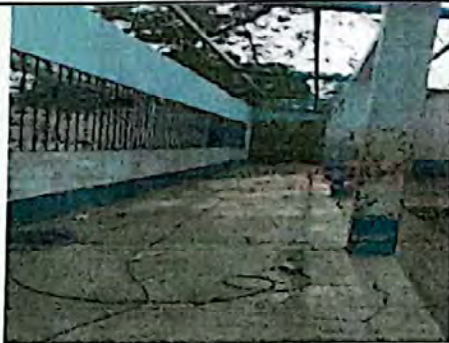
Foto 3: ESTADO DE PISO EN CORREDOR DE MODULO 1
