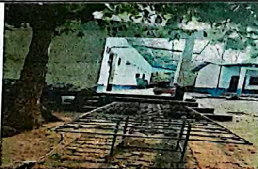
Foto 5: ESTADO DE BALCONES DE MODULO 1
