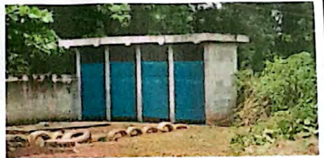
Foto 2: ESTADO FISICO DE MODULO DE SANITARIOS
