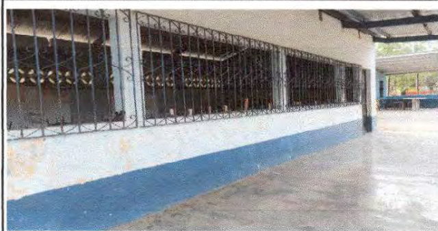
Foto 5: Estado de balcones de módulo 1
