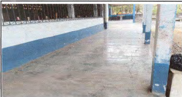
Foto 3: Estado de piso en corredor de módulo 1.
