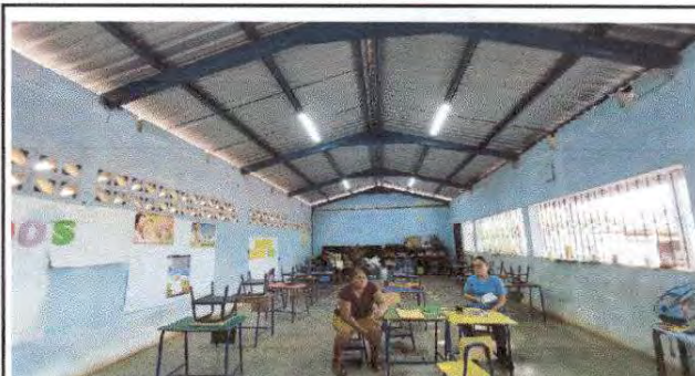
Foto 4: estado del interior de aula en módulo 1.
