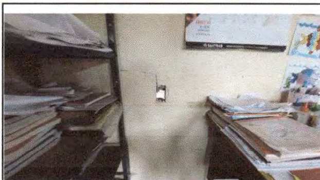
Foto 10: Falta de instalaciones eléctricas en aulas de módulo 2.
