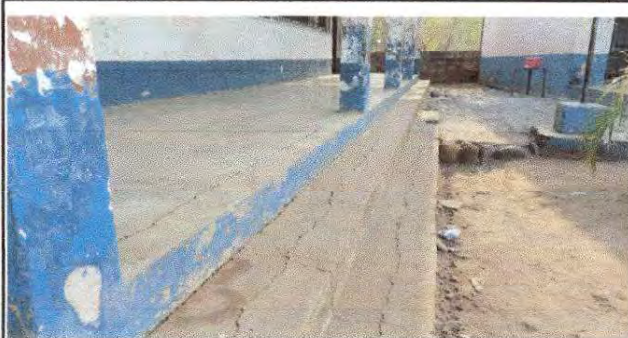
Foto 6: Estado de piso y banqueta en módulo 2.
