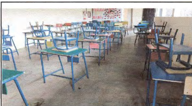
Foto 9: Estado de piso en aula de módulo 2.
