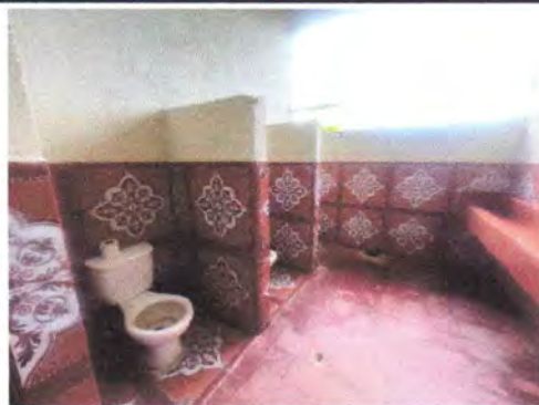
Foto 8: Inodoro en mal estado, requiere remozamiento, e instalación de puertas de metal.
