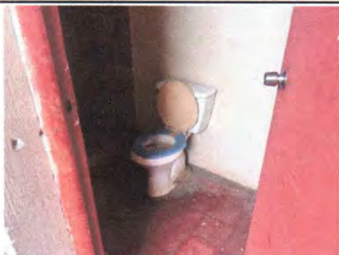
Foto 9: Inodoro en mal estado, requiere remozamiento.
