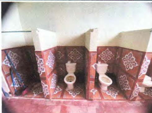
Foto 7: Inodoro en mal estado, requiere remozamiento, e instalación de puertas de metal.
