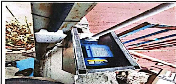
Foto 4: Instalación de Bomba presurizadora instalada.
