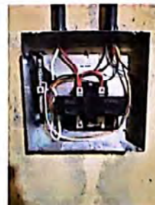
Foto 6: Sustrución de Tablero de flipones de 8 circuitos
