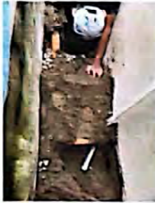
Foto 7: Mantenimiento Fosa Séptica
