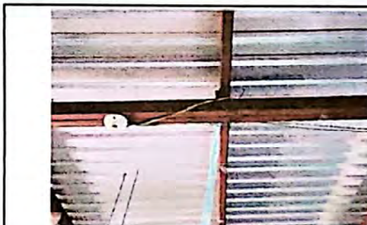
Sustitución de lámparas tipo led.
