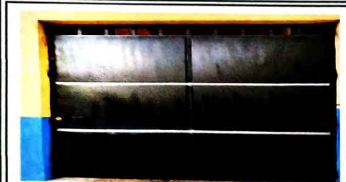
Foto 7: Portón de segunda entrada del centro educativo instalado.
