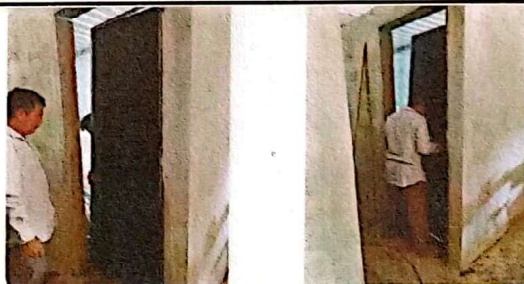
Foto 5: Sustrucción de puerta de Bodega y Área de Pozo
