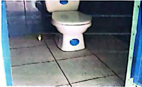
Foto 7: Sustrucción de torta de concreto por piso cerámico en servicios sanitarios
