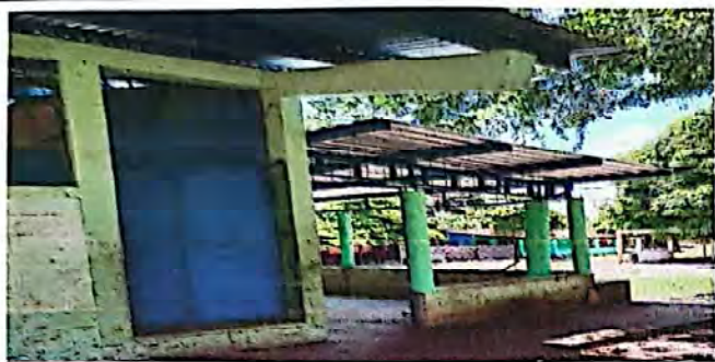
Foto 1: Sustrucción de estructura soporte de metal en servicios sanitarios
