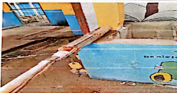
Foto 5: MANTENIMIENTO DE BOMBA Y CISTERNA
