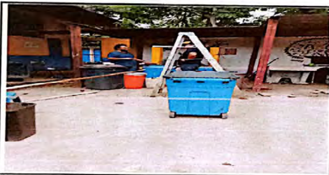
Foto 3: MANTENIMIENTO DE BOMBA Y CISTERNA
