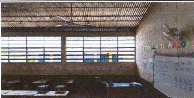
Foto 9: Vista de ventiladores de techo y de pared instalados al 100%
