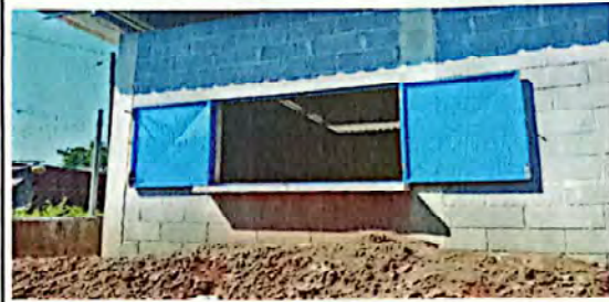
Foto 2: Sustrucción de ventana
