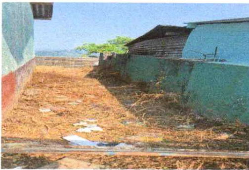
Foto 3: MURO PERIMETRAL EN DESCOMPOSICION
