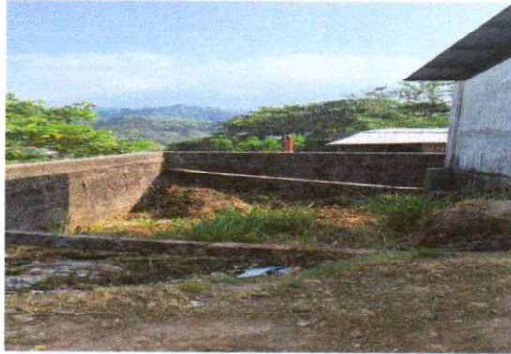
Foto 1: MURO PERIMETRAL DETERIORADA
