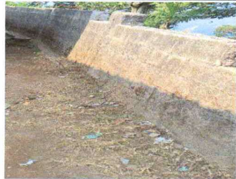
Foto 2: MURO PERIMETRAL EN MAL ESTADO
