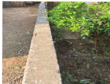
Foto 4: FACHADA DE MURO EN MAL ESTADO
