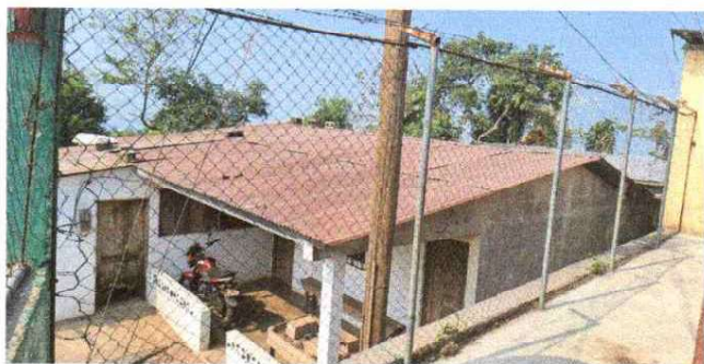
Foto 3: VISTA DE CIRCULACIÓN EN MAL ESTADO DEL ESTABLECIMIENTO
