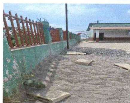
Foto 4: FACHADA DE MURO PERIMETRAL DETERIORADO
