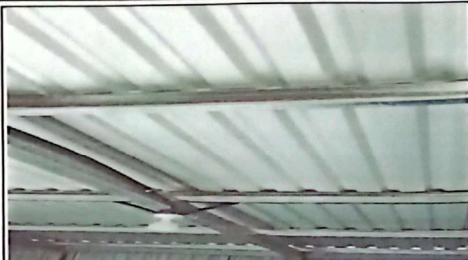
Foto 2: Sustrucion de estructura del techo.
