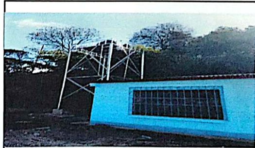
Foto 4: vista suministro de sistema eléctrica finalizada
