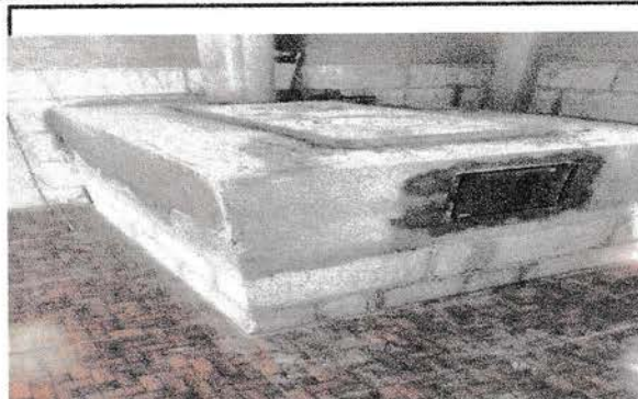
Foto 2: SUMINISTRO DE ESTUFA DE COCINA
