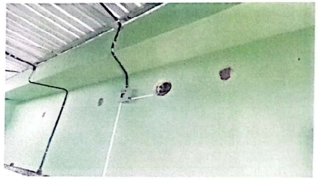
Foto 2: Vista de tubería conduit y canaleta y contador de mejoramiento de instalación eléctrica de fuerza e iluminación en cocina
