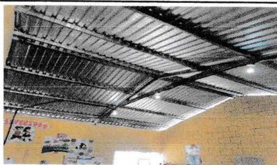
Foto 2: Vista de la lamina troquelada, estructura de soporte con metal galvanizado y sistema electrico del interior del aula
