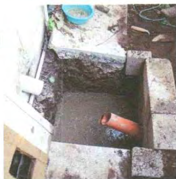
Mantenimiento de caja de registro.
