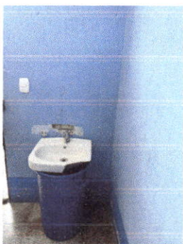
Foto 9: LAVAMANOS DEL MÓDULO DE BAÑOS ESTA QUEBRADO
