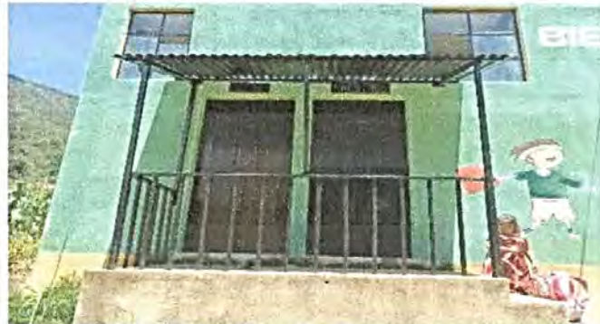
Foto 20: Pestaña de las puertas del baño exterior
