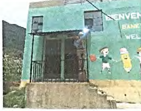
Foto 20: Pestaña de las puertas del baño exterior
