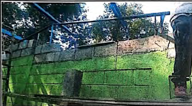
SUSTITUCIÓN DE MOJINETE
