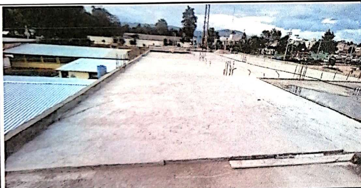
Foto 3: PAÑUELOS E IMPERMEABILIZACION DE TERRAZA
