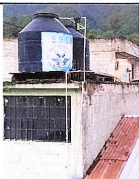
Foto 5: Línea de descarga de depósito 2 y 3 hacia línea general.
