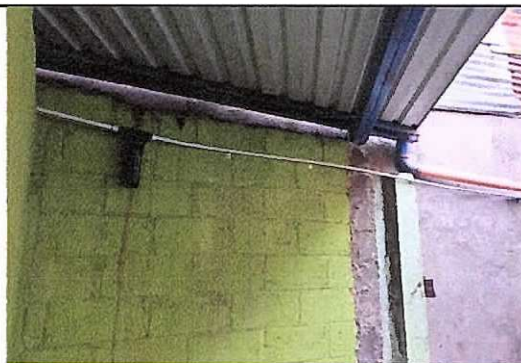
Foto 4: Línea de descarga de depósito 1, hacia la cocina.
