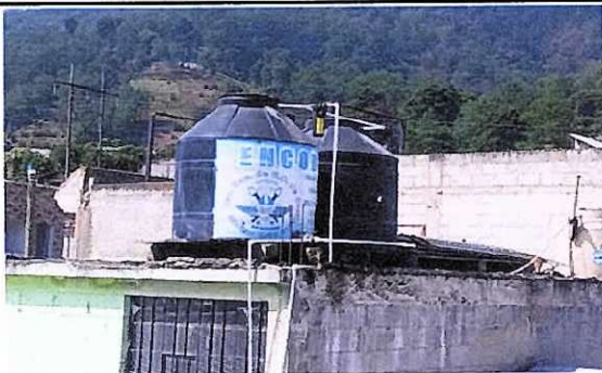
Foto 5: Depósitos de Agua 2 y 3
