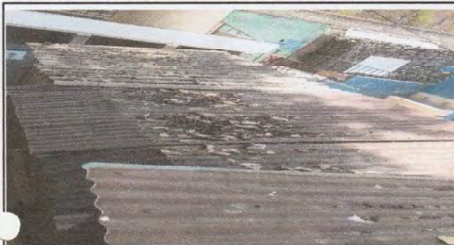
Foto 1: Laminas en ma estado de los baños
