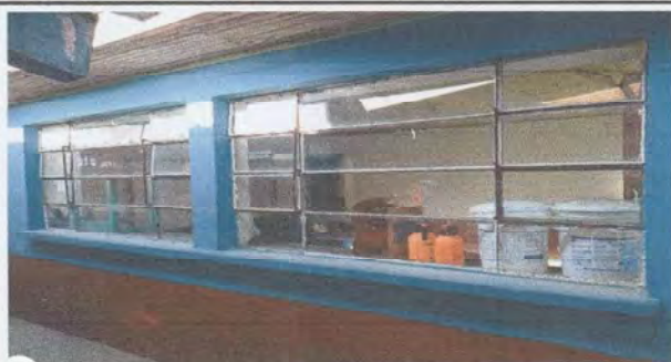
Foto 1: Ventanas de aulas de parvulos y 4to grado sin balcones
