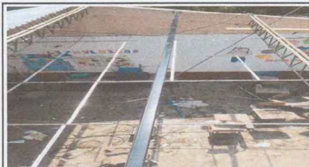
Foto 4: RETIRO TOTAL DEL CIELO FALSO EN EL AULA DE 5TO GRADO
