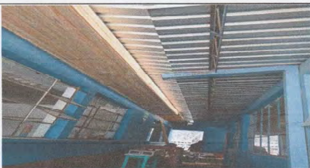
Foto 3: Aulas sin balcones
