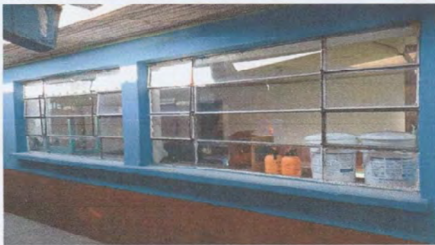
Foto 3: Aulas sin balcones
