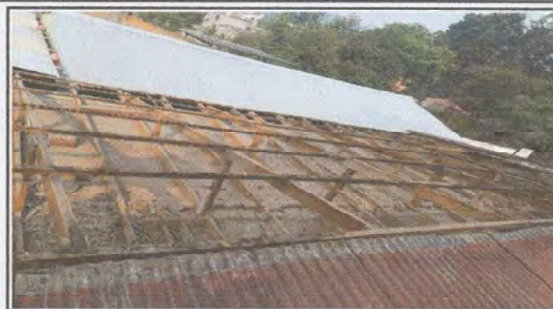
Foto 2: Vista superior de láminas que se sustituirán
