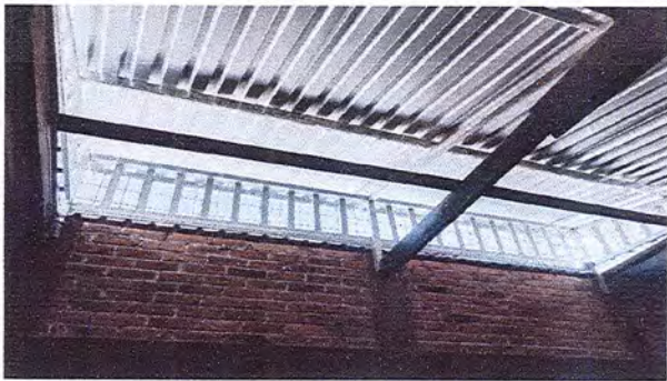
Foto 2: Entechado y entrada de aire
