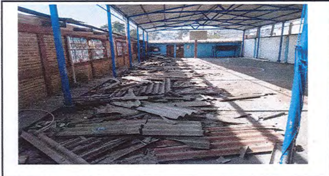
Foto 4: Escombros de techo retirado
