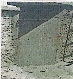
Foto 5: COLUMNA EN LA GRIETA
