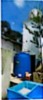
Foto 1: Depósito de agua de 2,500 lts con bomba sumergible de 1HP
