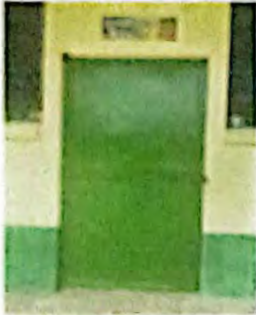
Foto 1: Sustrucción de chapa, mantenimiento de pintura y estructura.
