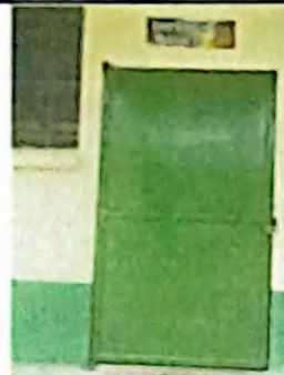
Foto 3: Sustrucción de chapa, mantenimiento de pintura y estructura.
