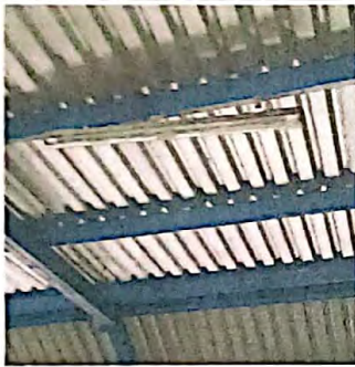
Foto 3: Sustrucción de cableado eléctrico sólido y sustrucción de lampara.
