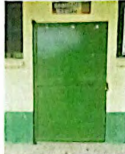
Foto 2: Sustrucción de chapa, mantenimiento de pintura y estructura.
